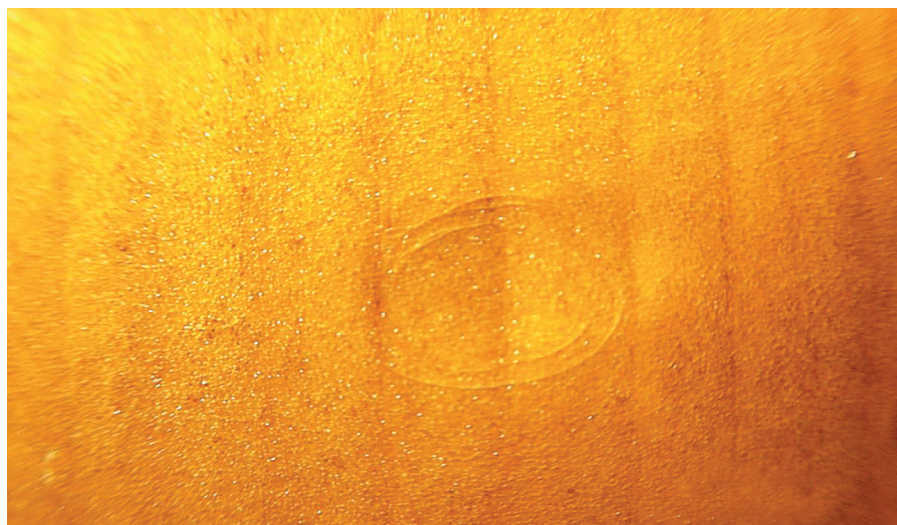
Značne poškodený (popraskaný) náterový film po údere ľadového krúpu. Poškodenie vidieť pri 30-násobnom zväčšení pod mikrolupou. Cez trhlinky sa dostáva vlhkosť a následne modrá hniloba.
